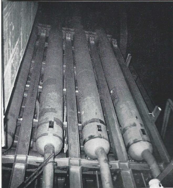
Ces longs tuyaux sont les cellules d'un demi-échangeur. Le gaz carbonique y arrive surchauffé et vaporise l'eau qui alimentera ensuite les turbines.
