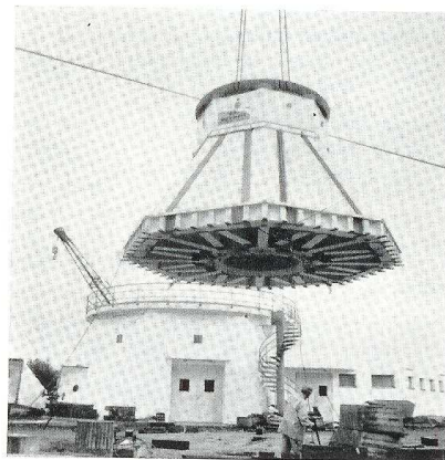
Ci-dessus le fût (66 tonnes) a été amené au niveau du bâtiment qui lui sert de socle.
