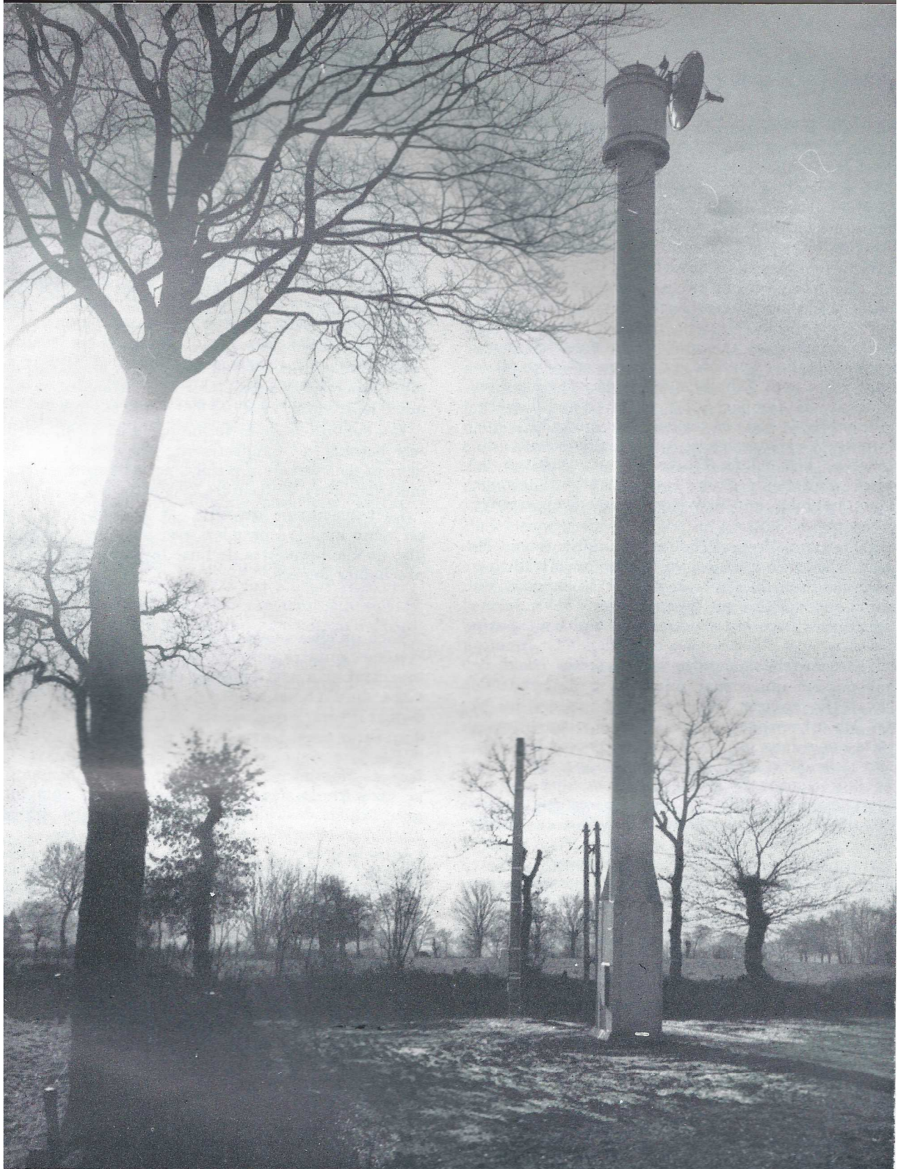
Pylône hertzien métallique autostable utilisé dans le réseau hertzien numérique de Basse-Normandie. Les équipements de transmission sont logés au sommet. Un socle de béton, disposé à la base, en assure le maintien.
